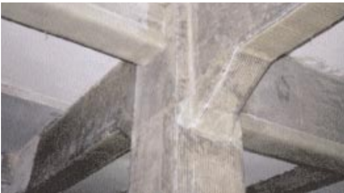
Λεπτομέρεια ενίσχυσης κόμβου με σύνθετα υλικά (Hotel Rendezvous, Σιγκαπούρη). Τα σύνθετα υλικά εφαρμόζονται ευκολότατα σε περιπτώσεις ενίσχυσης κόμβων δοκών - υποστυλωμάτων αυξάνοντας τη διατμητική αντοχή τους στα επιθυμητά επίπεδα.
